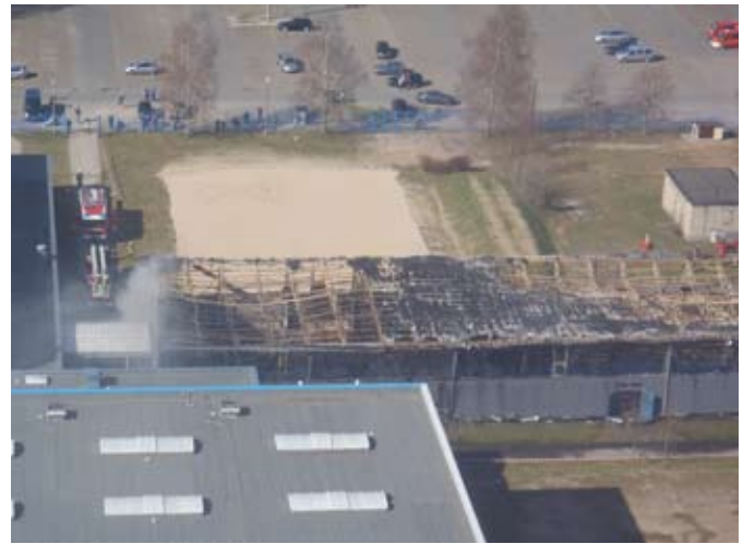
Brand der Laufhalle am Olympiastützpunkt
